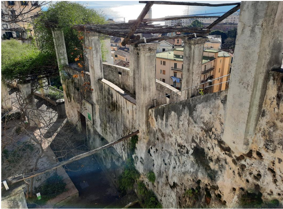
FOTO 14: Patologie dei muri dei terrazzamenti
