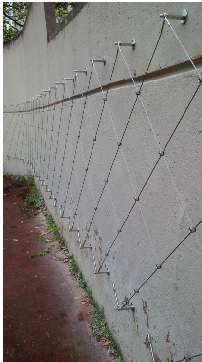
Figura 5: La struttura reticolare per il rampicante
