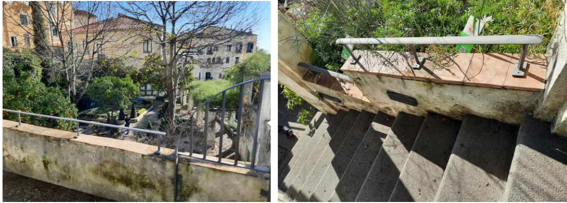
FOTO 17: I parapetti in più punti presentano altezze non a norma
