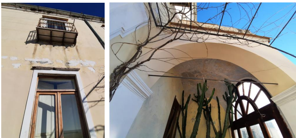
FOTO 18: Esempi di patologie rilevate
