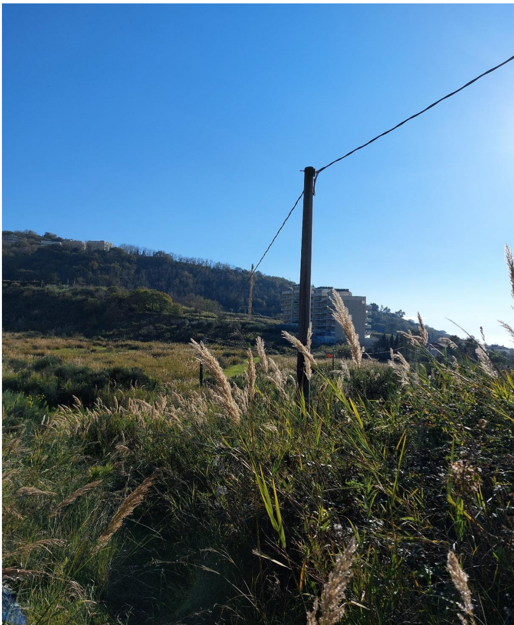
Foto 3: Prosecuzione linea aerea su pali presente nell’area d’intervento per alimentazione case coloniche presenti a confine dell’area interessata dall’intervento
