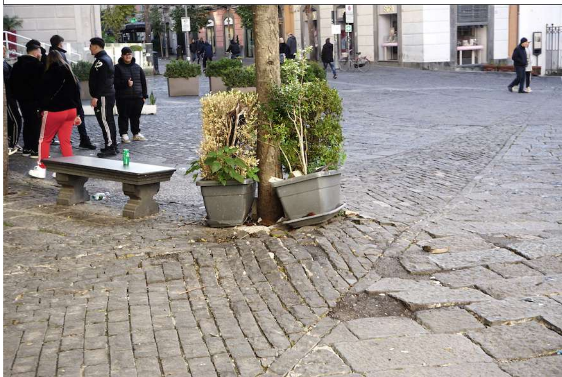
Pavimentazione dissestata da apparato radicale alberi
