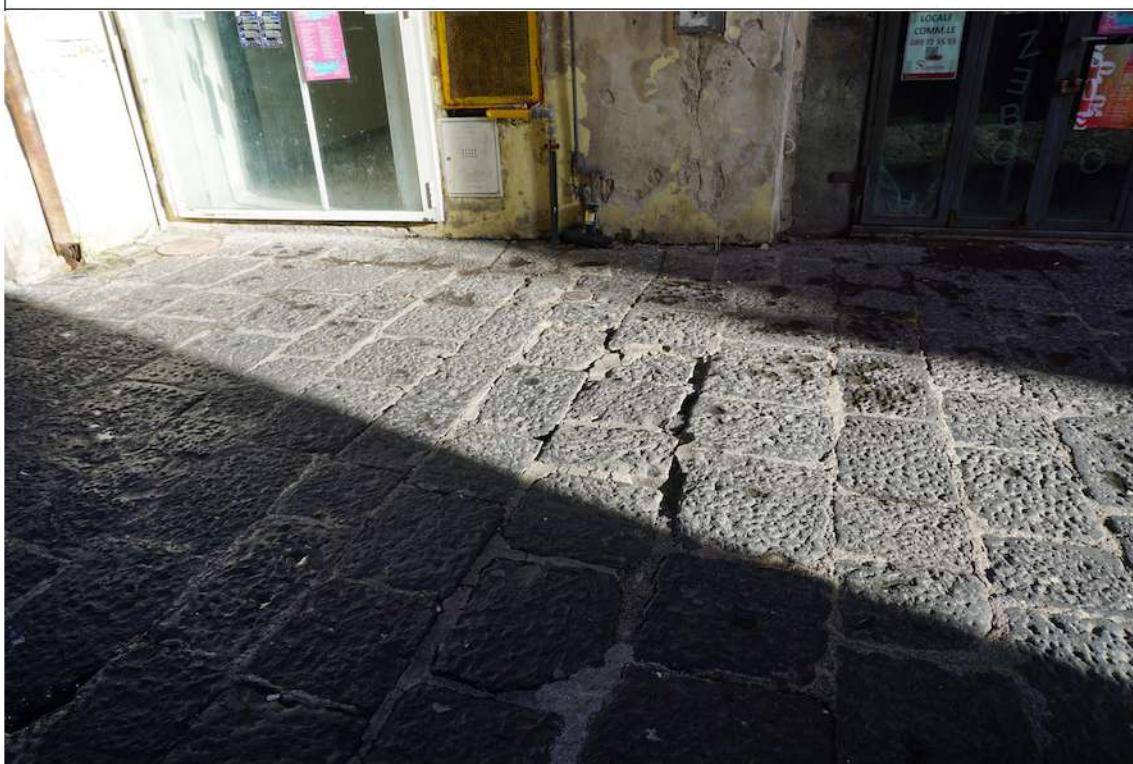
Sconnessione della pavimentazione
