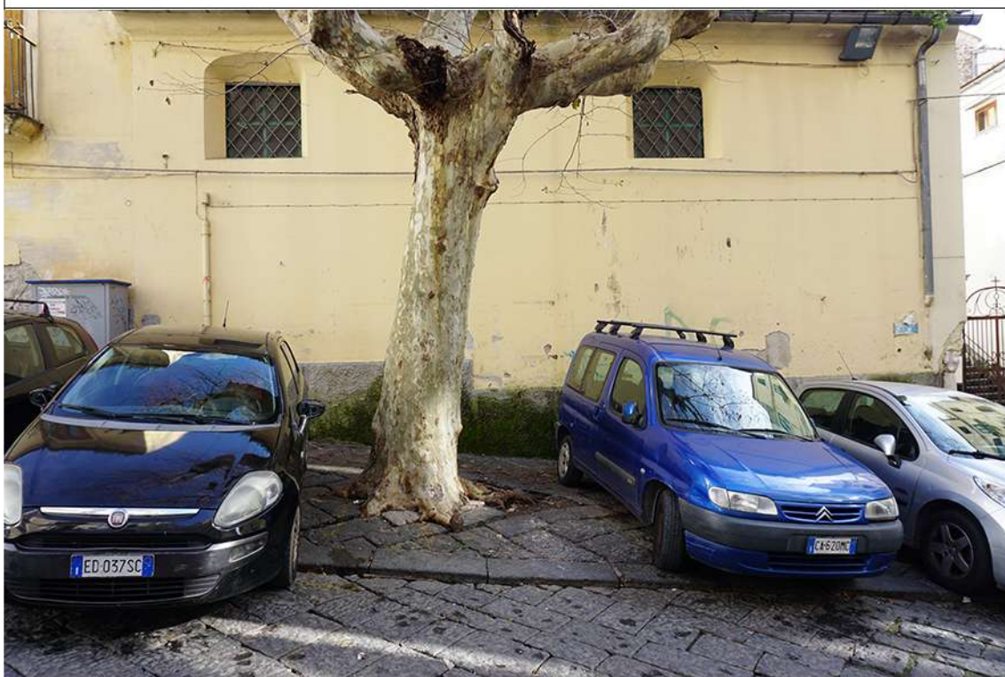
Pavimentazione dissestata da apparato radicale alberi
