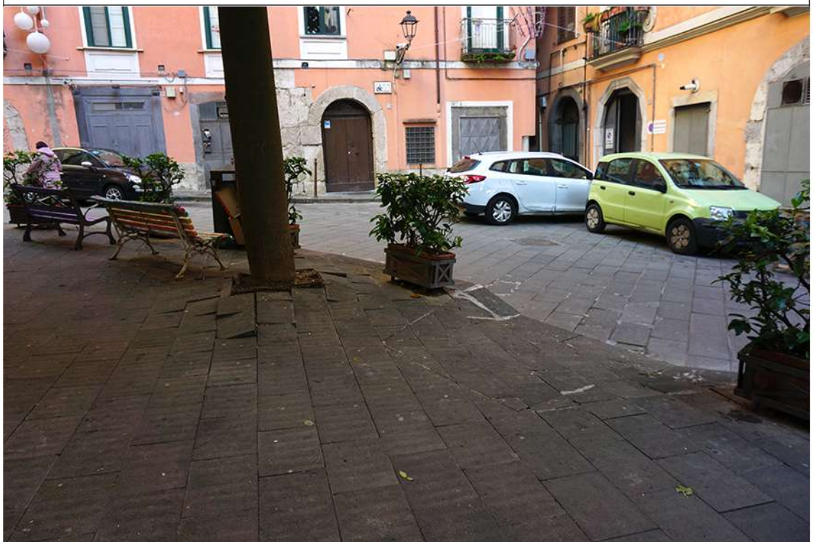
Pavimentazione dissestata da apparato radicale alberi
