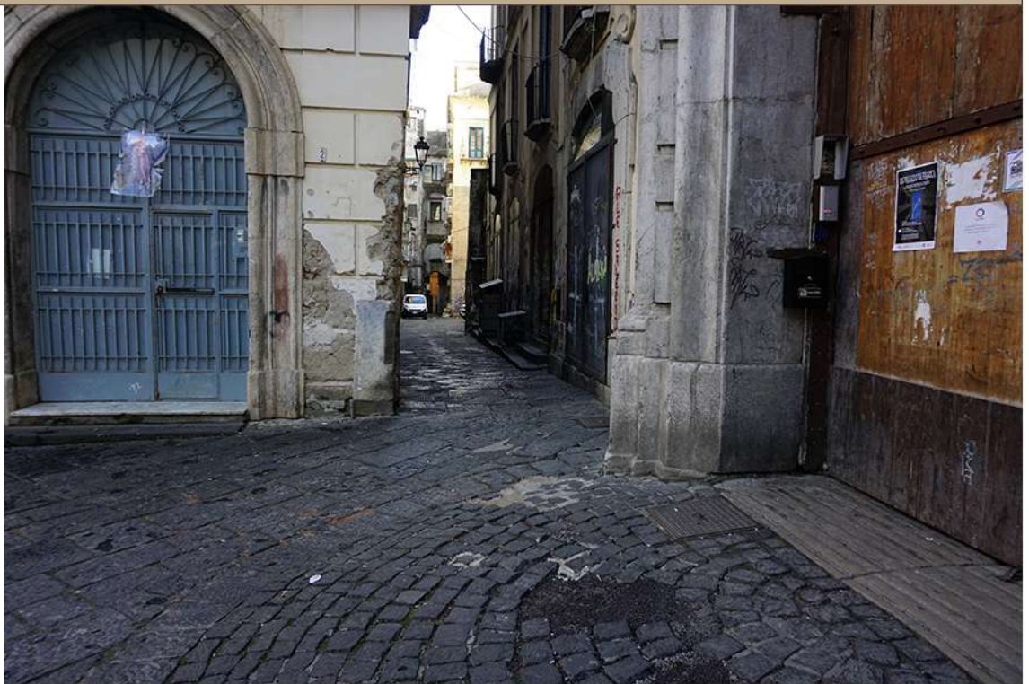
Sconnessione della pavimentazione
