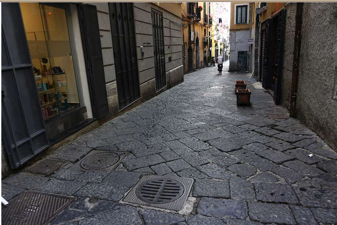
Sconnessione della pavimentazione
