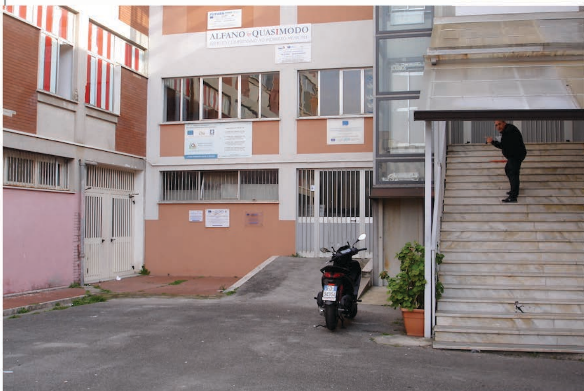
Rampa con pendenza eccessiva
